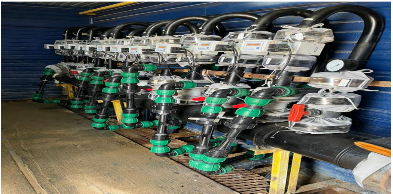
Рисунок 18 - Установленные окислители на линию выщелачивающего раствора
